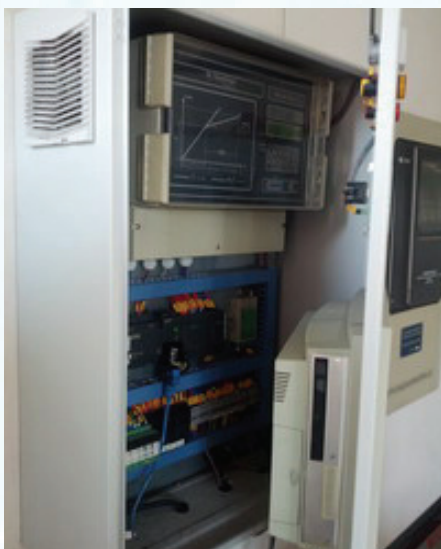
主控制柜内部
